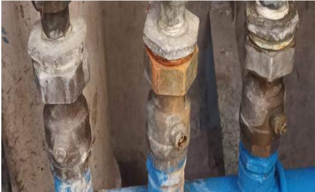
A. Kondisi handle valve sudah getas dan mudah sekali patah / rusak
